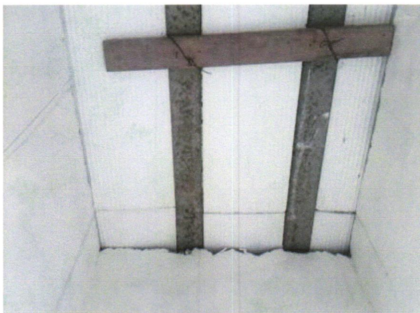
FOTO 01 – Laje pré-fabricada treliçada para piso ou cobertura, intereixo 38cm, h=12cm, el. enchimento em EPS h=8cm, inclusive escoramento em madeira e capeamento 4cm.
